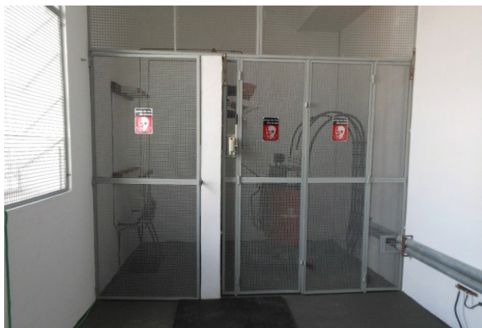
Sala da subestação de energia: ambiente restrito.
