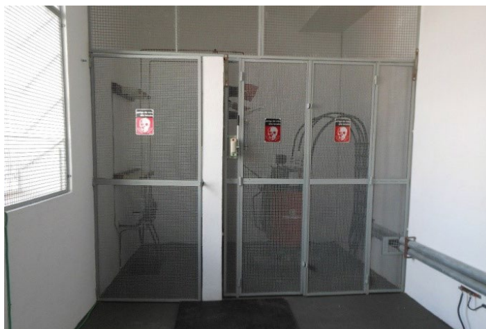
Sala da subestação de energia: ambiente restrito.
