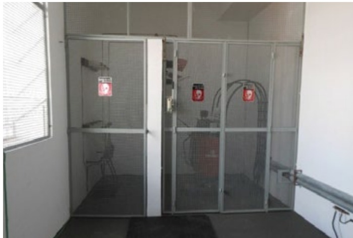
Sala da subestação de energia: ambiente restrito.
